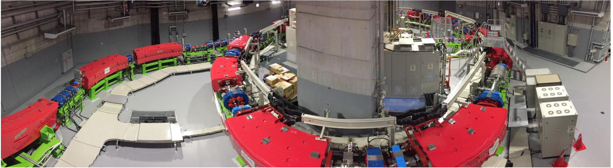
加速器室 (シンクロトロン)
