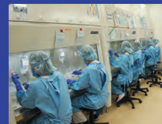
[オンコロジーセンター棟抗がん剤調製室]
